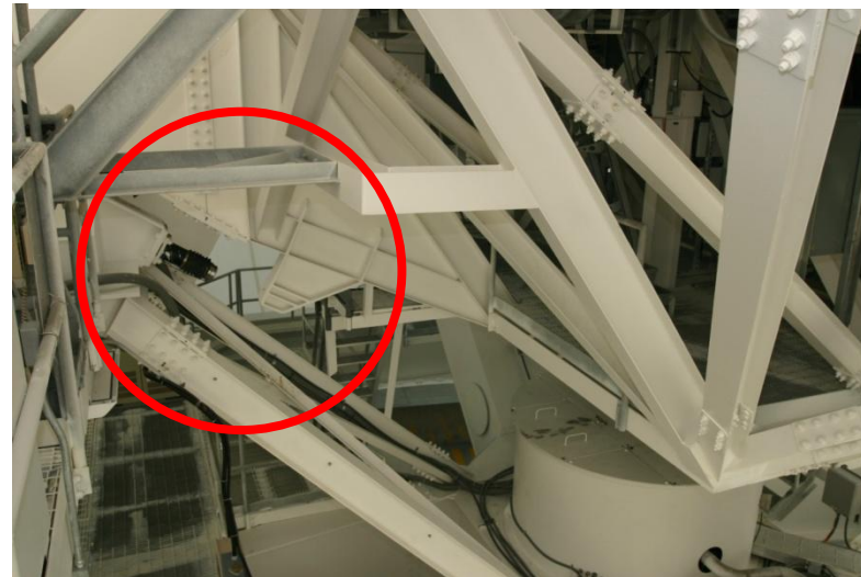
Elektromechanický omezovač minimálního polohového úhlu sklonu antény radiolokátoru stanice EBR (+2°)
